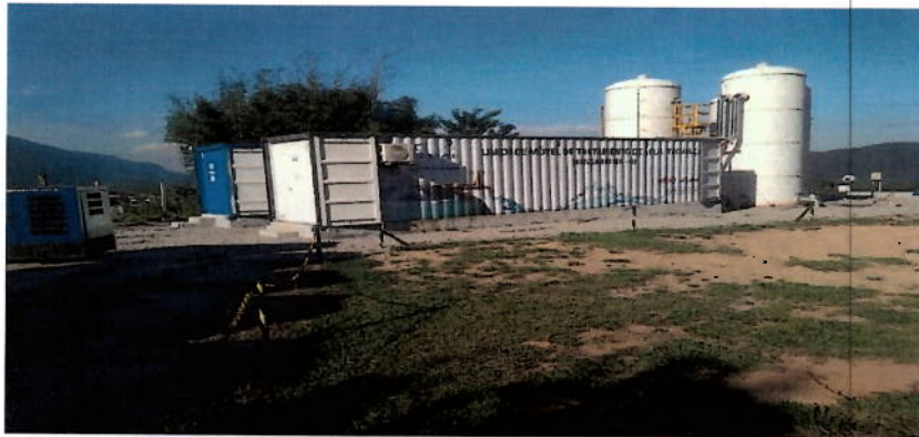
Foto 27 – Unidade Móvel de Tratamento de Água Itacuruça.
