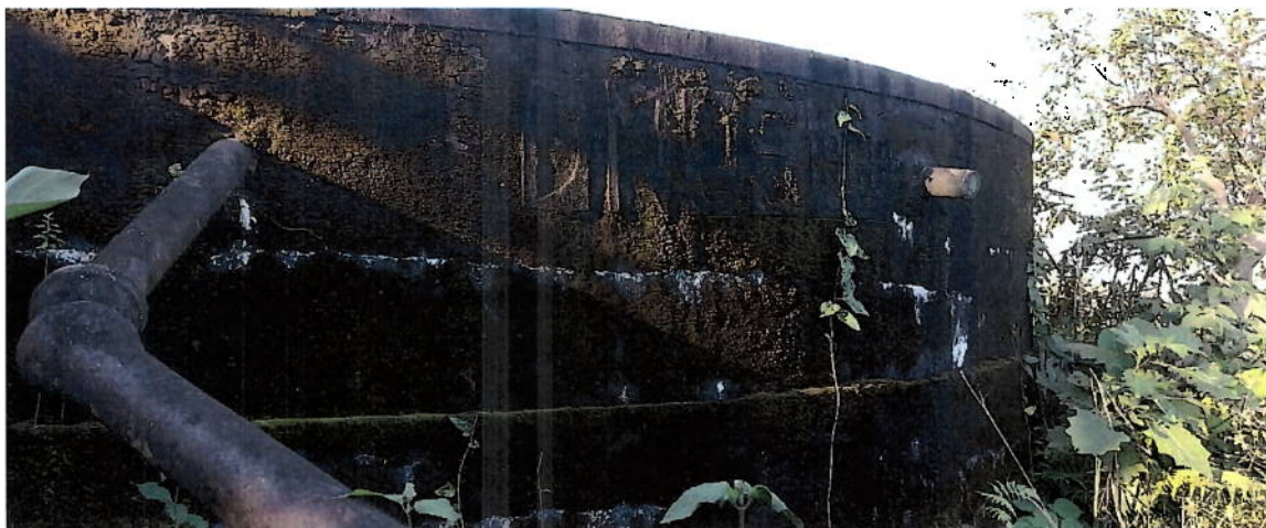
Foto 21 – Reservatório com capacidade de 200 m 3 .
