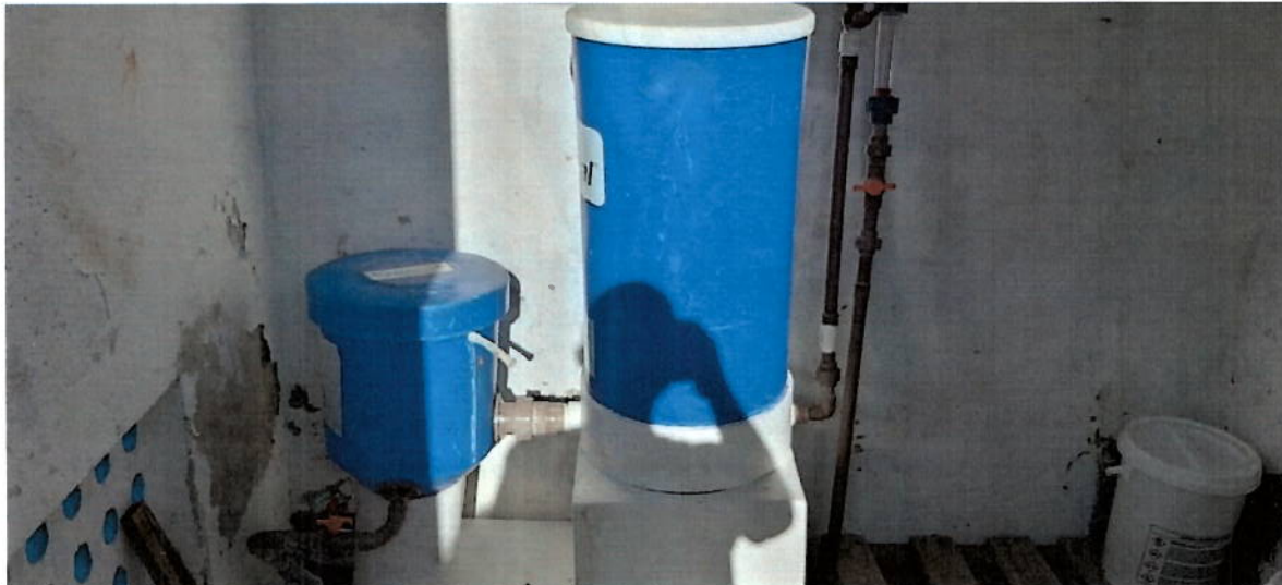
Foto 25 - Sistema de desinfecção com Hipoclorito de Cálcio em pastilhas.
