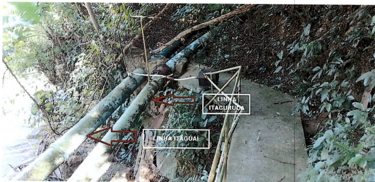
Foto 20 – Adutoras das linhas Itaguaí e Itacuruça.
