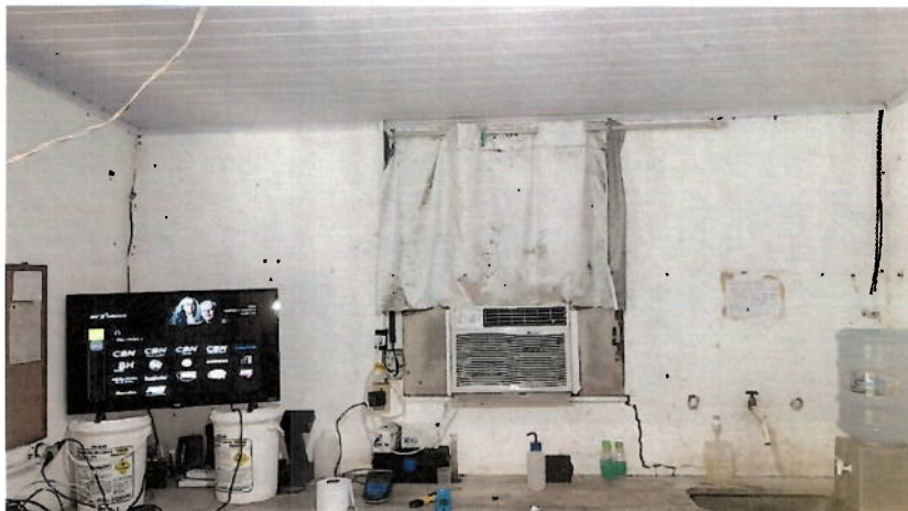
Foto 08 - Posto de Operação com várias rachaduras e trincas nas paredes do imóvel. Há necessidade de reforma e recuperação do imóvel. Não atende as NR 17; NR 24 e a NHO 11 da Fundacentro.
