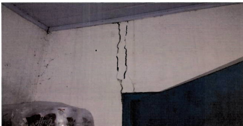
Foto 09 - Posto de Operação com várias rachaduras e trincas nas paredes do imóvel. Há necessidade de reforma e recuperação do imóvel. Não atende a NR 24.
