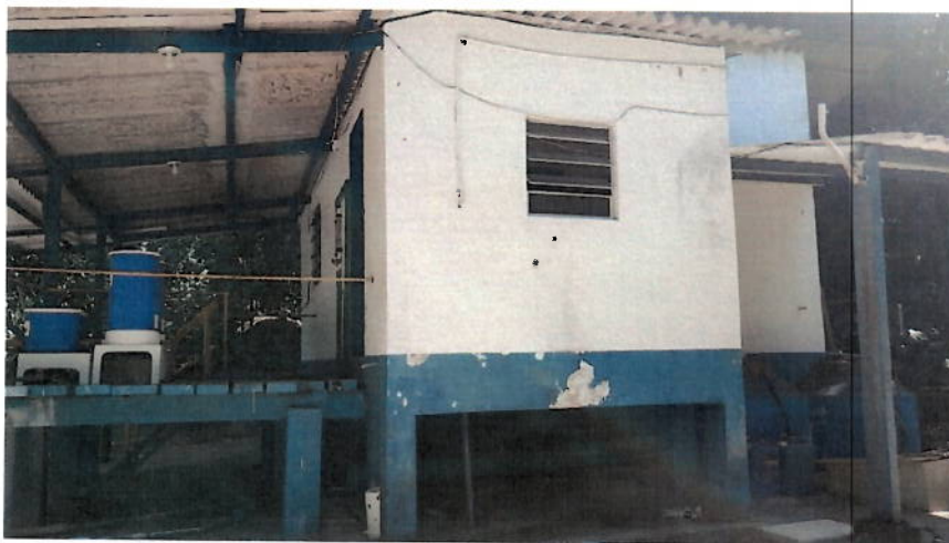
Foto 11 – Posto de Operação. Há necessidade de reforma e recuperação do imóvel. Não atende a NR 24.
