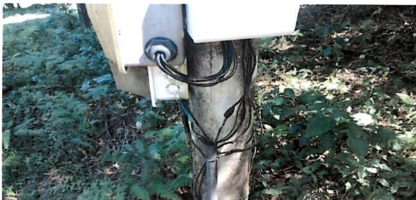
Foto 02 - Posto de Operação. Quadro medidor de energia elétrica. Não atende a NR 10 e NBR 5410. Risco de ocorrência de acidentes elétricos.
