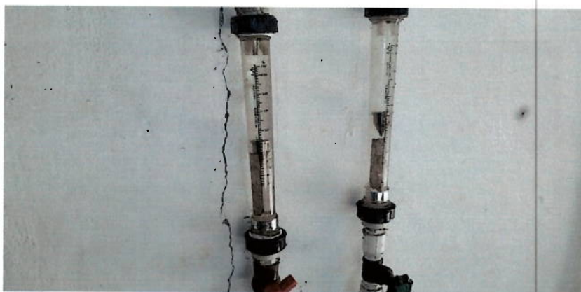
Foto 07 – Rotômetros. Ao fundo rachaduras e trincas nas paredes do imóvel. Há necessidade de reforma e recuperação do imóvel. Não atende a NR 24.
