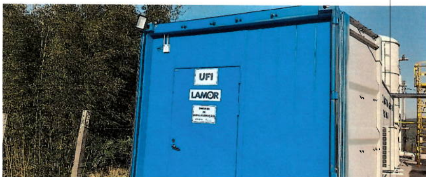
Foto 33 – Unidade de Ultrafiltração 1.
