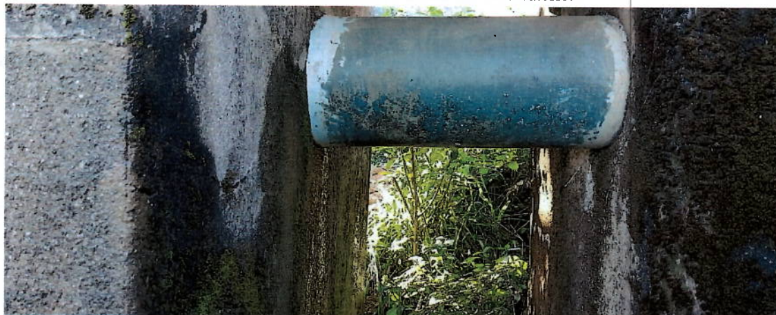
Foto 23 - Sinais de vazamentos no reservatório.
