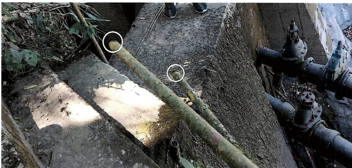
Foto 17 – Guarda-corpo precisando de manutenção preventiva e corretiva.
