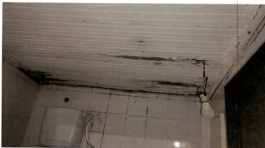
Foto 12 – Posto de Operação - Teto do Banheiro apresentando ambiente insalubre e instalação elétrica inadequada. Não atende a NR 24 e ligações de circuito não estão de acordo com a NBR 5410.
