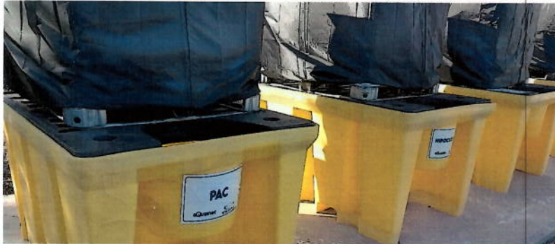
Foto 29 – Bacia de contenção para possíveis vazamentos de produtos químicos.
