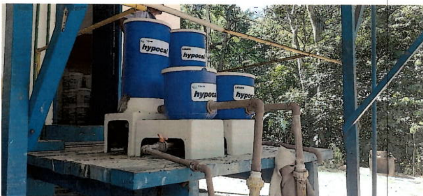
Foto 05 - Sistema de desinfecção com Hipoclorito de Cálcio em pastilhas.
