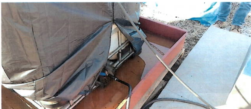
Foto 31 – Bacia de contenção para o tanque de biodiesel.
