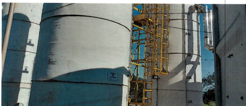
Foto 36 – Tanques de contato da Unidade de Tratamento.
