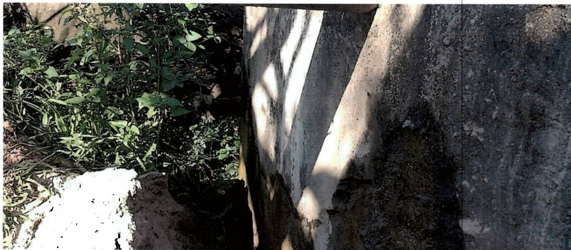
Foto 22 - Sinais de vazamentos no reservatório.
