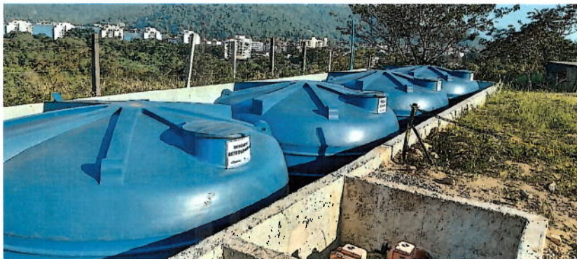
Foto 37 – Tanques de descarte de resíduos e retrolavagem da Unidade.
