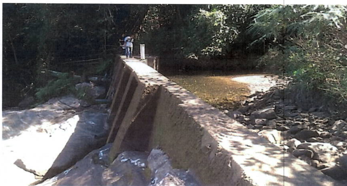
Foto 16 – Barragem Itinguçu (ausência de guarda-corpo ou mecanismo alternativo de segurança).
