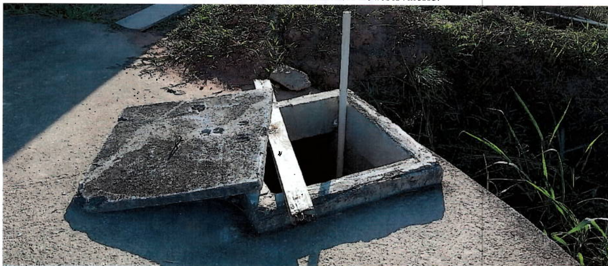
Foto 24 - Tampa de inspeção do Reservatório (não oferece estanqueidade para proteção da água clorada), medidor de nível inadequado.
