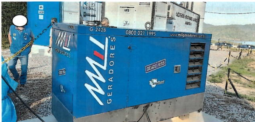
Foto 30 – Gerador de Energia da Unidade Ultrafiltração.
