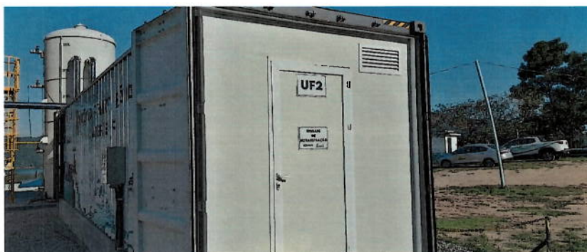
Foto 32 – Unidade de Ultrafiltração 2.
